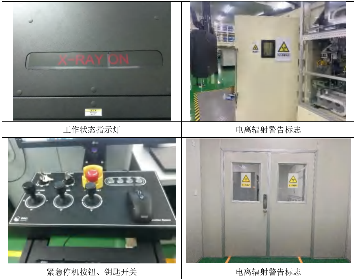
图 3-2 辐射防护安全措施情况现场图
