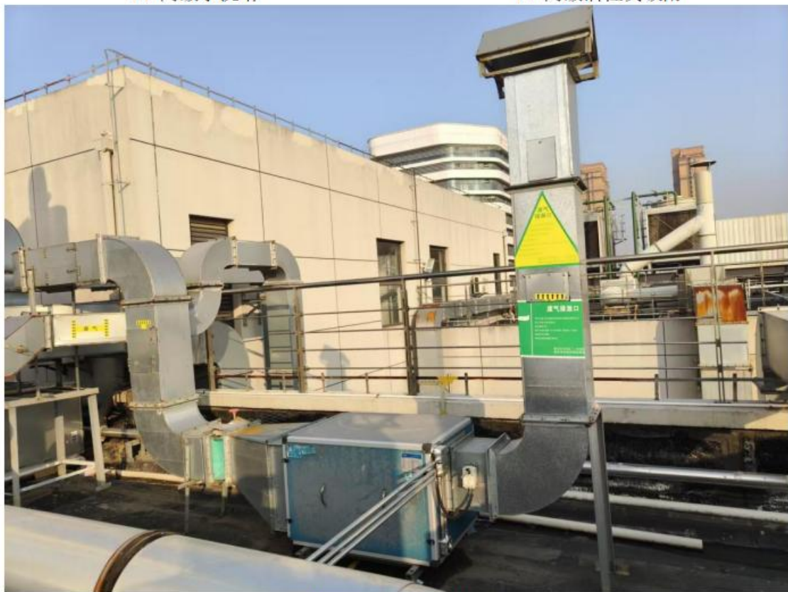
P8 排气筒活性炭吸附装置
