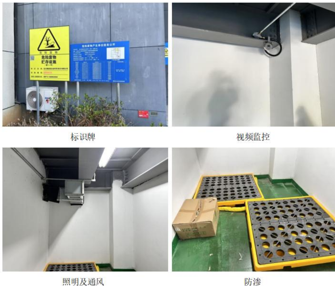
图 4.1-3 危废暂存间图
