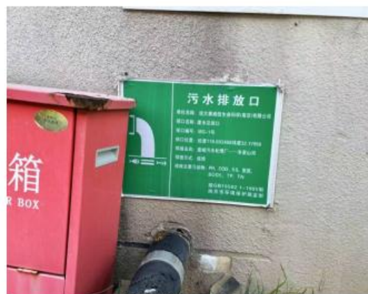
污水排放口标识牌
